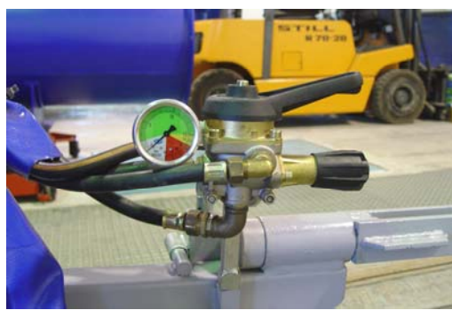
REGULADOR I DISTRIBUIDOR
